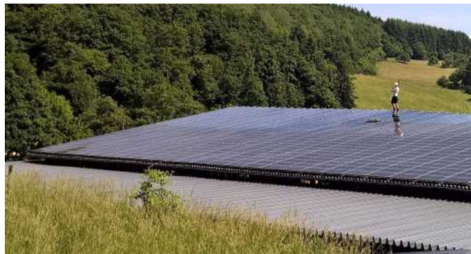
Photovoltaikanlagen regelmäßig warten lassen.
